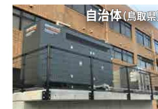
機種：インダストリアル 型番：SG130 燃料：LPガス 用途：BCP対策 補助金：石油災害ハルク等の導入事業費補助金
